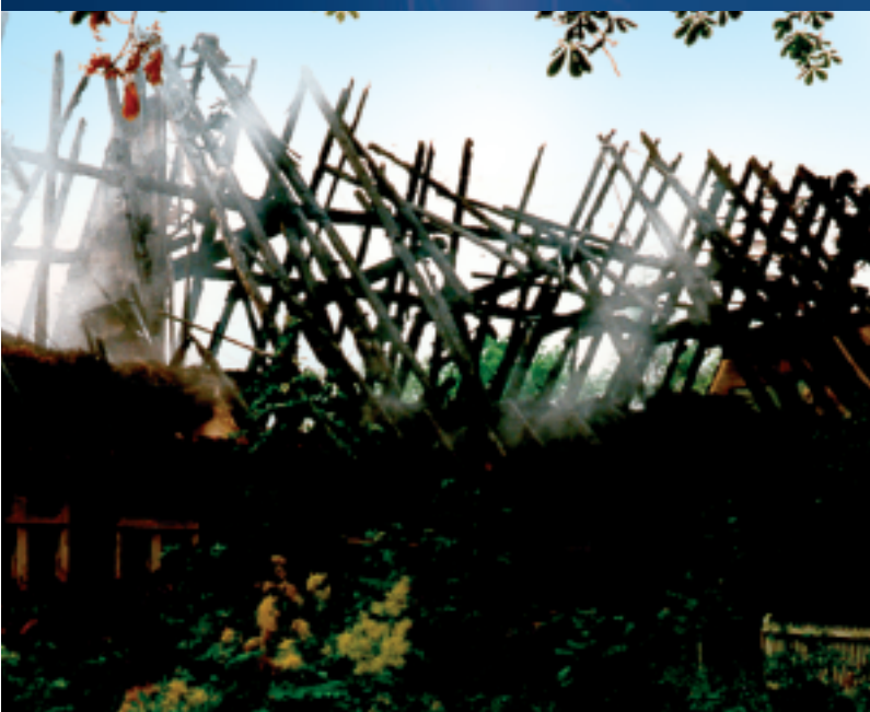
Blitzeinschlag in das historische Rathaus von Worpswede. Entstandener Schaden: ca. 1,7 Mio €.
